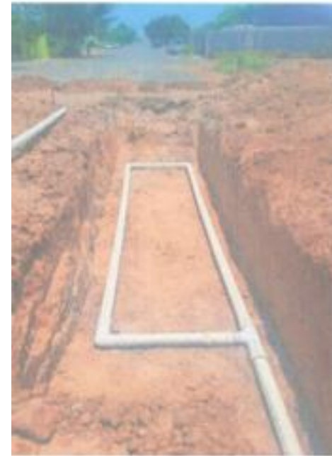
TUBERÍA PARA RETORNO
